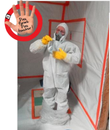
Source photo 1 : Visuel de la campagne "Pas formé, pas toucher". - © OPBBTP Source photo 2 : BTP CFA VIENNE
